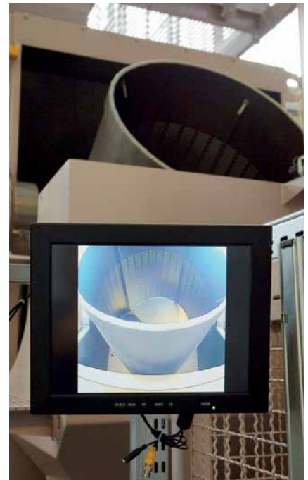
Ein Monitor ermöglicht die Überwachung des Füll- und Entleervorgangs
