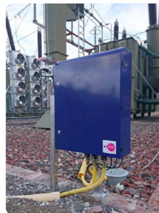
SIPP™ Node installiert an der Ölauffangwanne des Transformators
