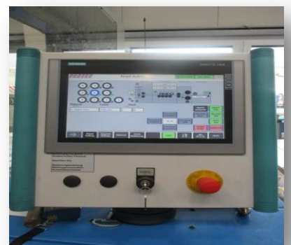
Große Siemens Touch Screen Steuerung
