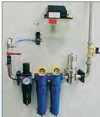
Sterilluft-Filtereinheit und Zentralschmierung
