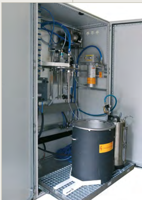
Materialversorgung mit Deckelheber, Durchlauferhitzer und isolierten beheizbaren Tank
