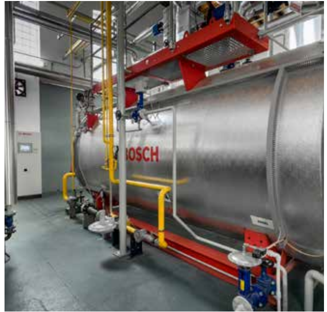
Die Zeiten, in denen eine ständige Anwesenheit im Kesselhaus notwendig war, sind lange vorbei.
