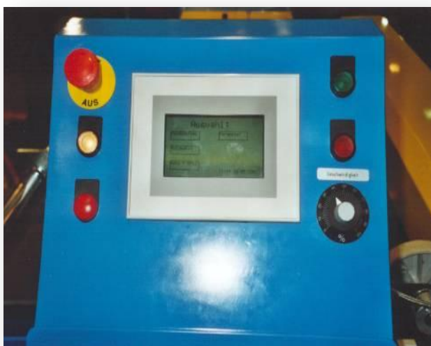
Steuerung Touch Screen ( Siemens Steuerung)
